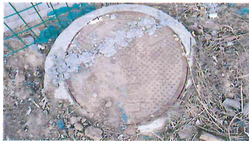
项目内下水井
