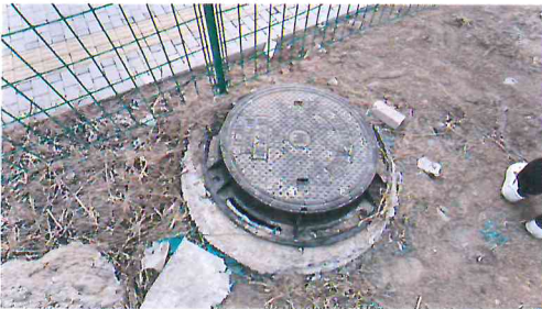
项目内上水井
